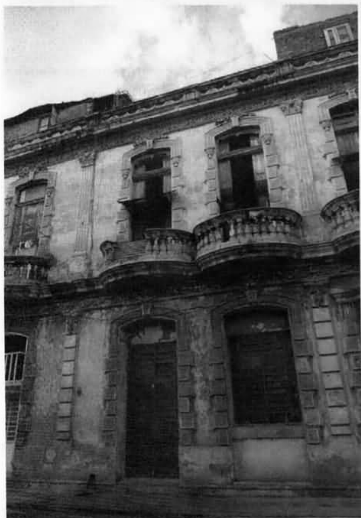
圖123・二樓的陽臺坍塌了，主人用綠色塑膠板擋著。仔細看這些建築，可以看出原來這些建築都是很精美的歐式建築，與馬德里、巴塞隆納、巴黎、蘇黎世的建築不相上下。
